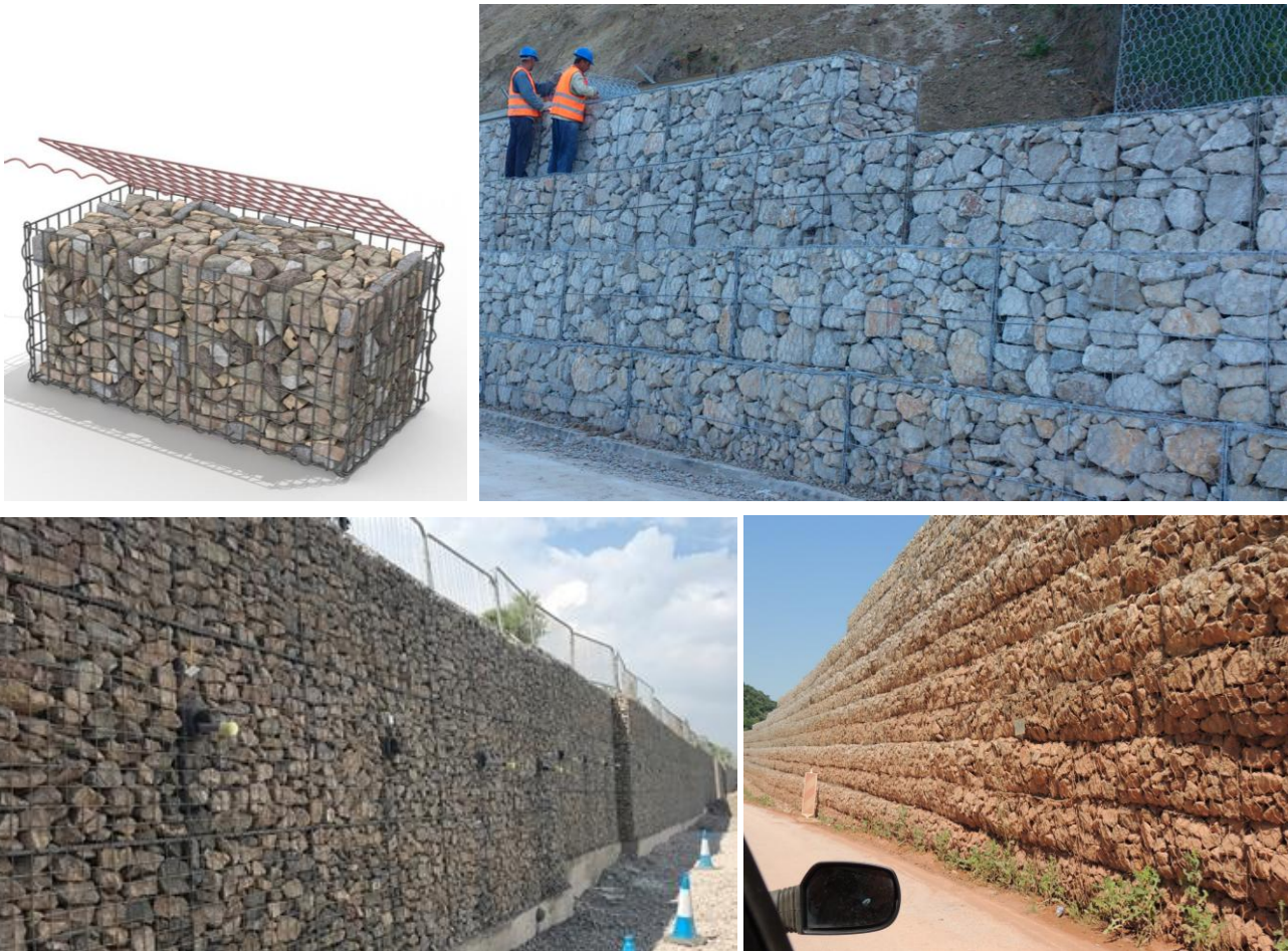
Slika 27. Potporni zidovi od gabiona – primeri dobre i loše izrade
