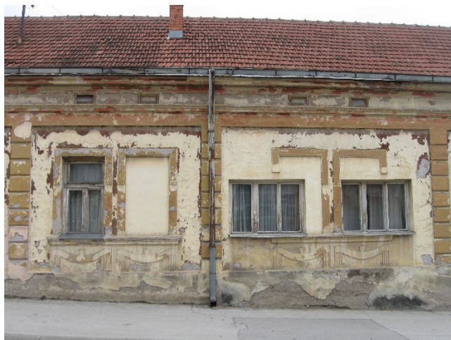
Slika 14 – Neuspešne intervencije na gradskoj arhitekturi, narušen rutam otvora (dokumentacija autora)
