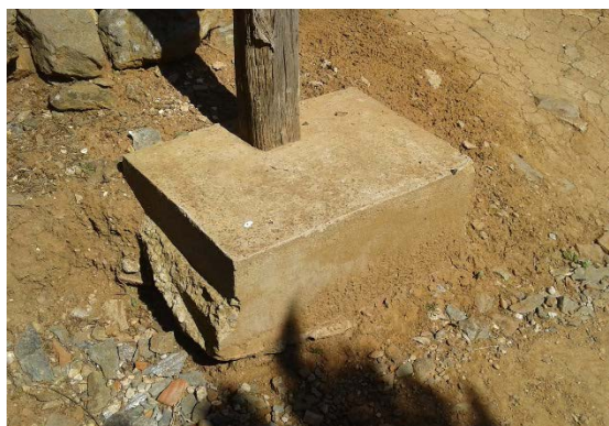
Slika 4 – Betonska stopa drvenog stuba zamenjuje izvorno kamenu (dokumentacija autora)
