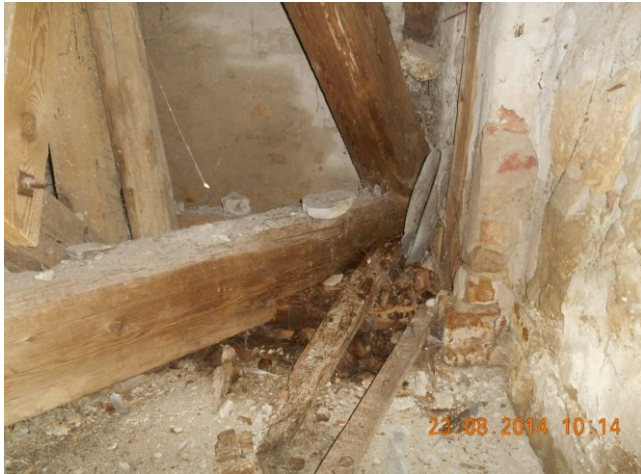
Slika 13. Oštećenje jastuka i kraja desnog ugaonog zakošenog stuba sa parkovske strane kupole.
