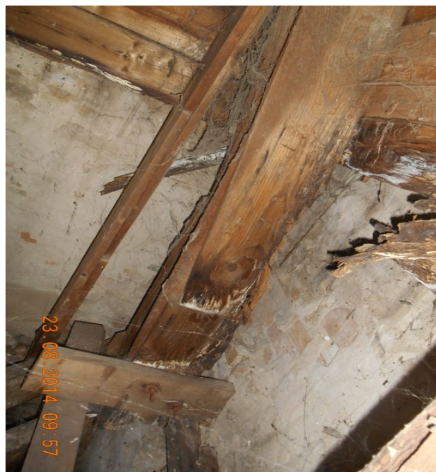
Slika 10. Oštećenja u zoni oslanjanja zakrivljenih nosača.
