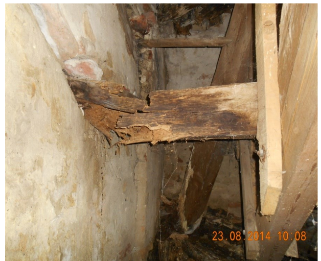
Slika 12. Deterioracija elemenata za ukrućenje prostorne konstrukcije kupole.
