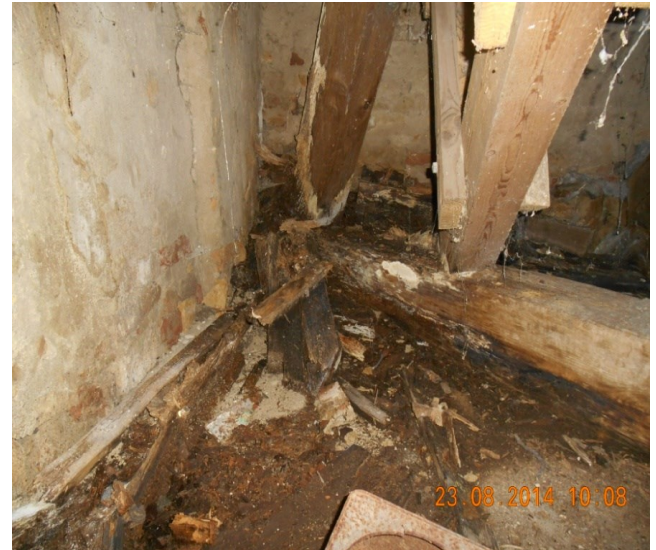
Slika 11. Potpuno propadanje jastuka i kraja levog zakošenog stuba sa parkovske strane kupole.
