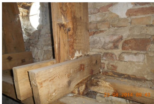
Slika 9. Oštećenja u zoni oslanjanja zakrivljenih nosača.
