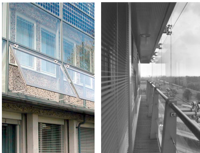
Slika 2 – Strujanje vazduha se obezbeđuje mehaničkim otvaranjem otvora na dnu i vrhu fasade
