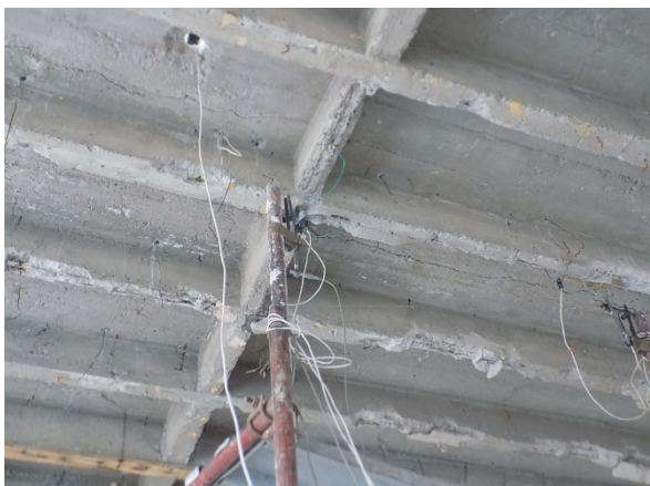
Foto 1 – Karakterističan izgled konstrukcije (rebra i ploča) i karakteristična oštećenja (segregacija betona i ogoljenost armature nosača-rebara zbog oštećenja betona). Raspored mernih instrumenata u polovinio raspona (LVDT i merne trake).
